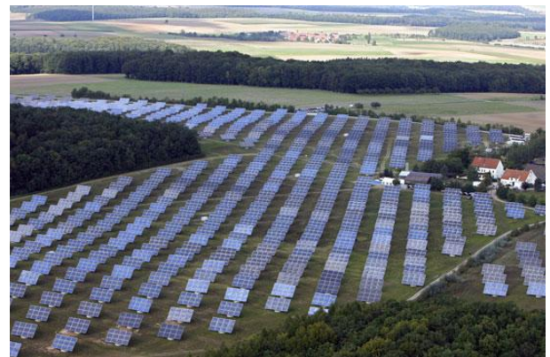
Foto de una central solar fotovoltaica
