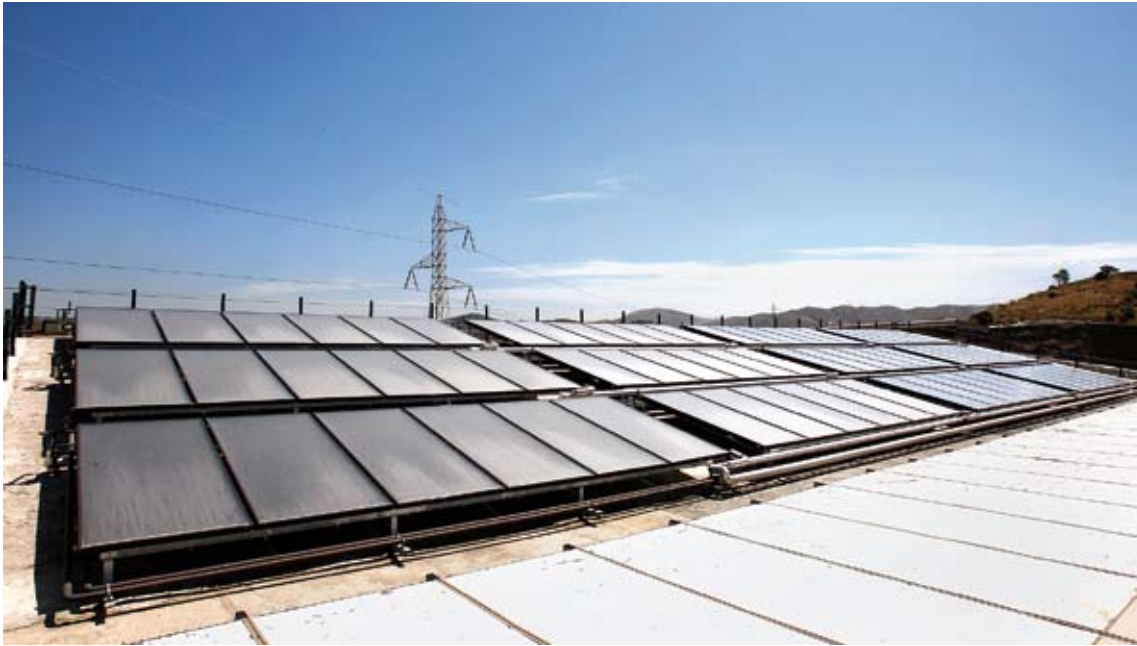
Captadores solares térmicos.
