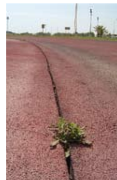
Canal de evacuación de aguas en pista de Atletismo. Se deben limpiar estas canales semiocultas para evitar que se colmaten o crezcan plantas.
