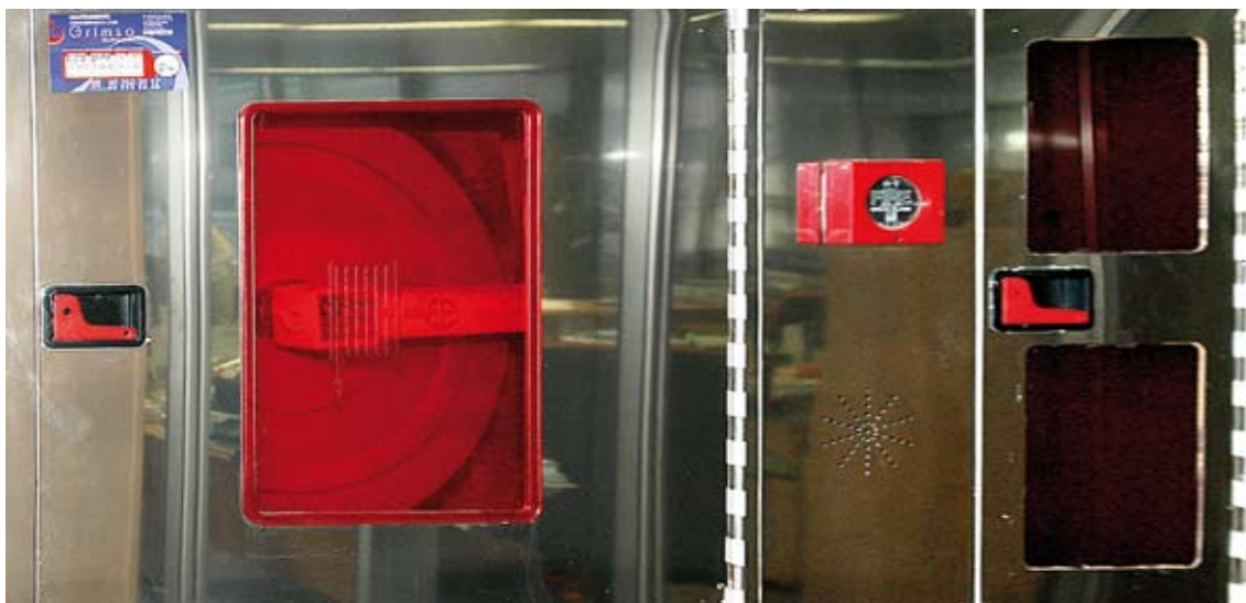
Armario BIE pulsador de emergencia y extintor.
