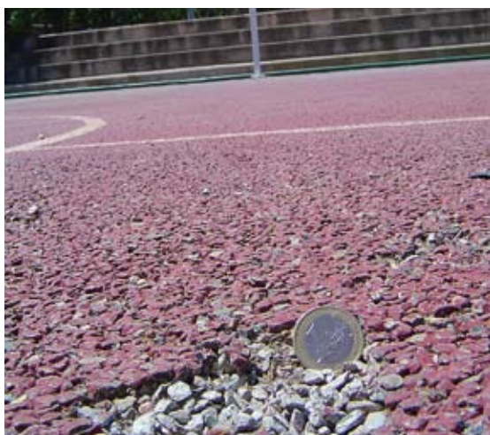
Desperfectos superficiales en un pavimento de hormigón poroso.
