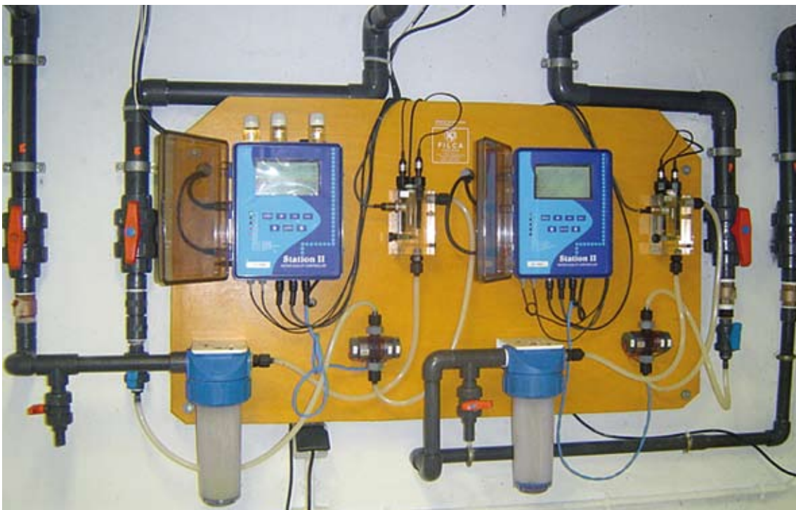
Sistema automatizado dosificación producto químico.
