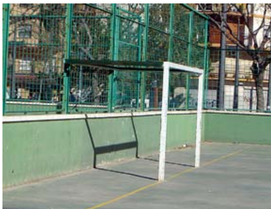
Anclaje antivuelco de portería de exterior.
