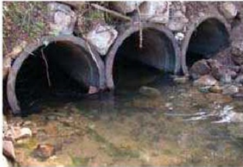
Vertido de aguas residuales
