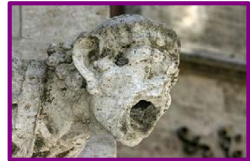
Corrosión de monumentos.
