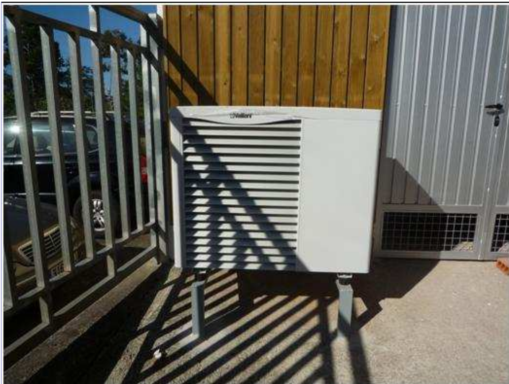
Bomba de calor para a calefacción e a produción de AQS.
