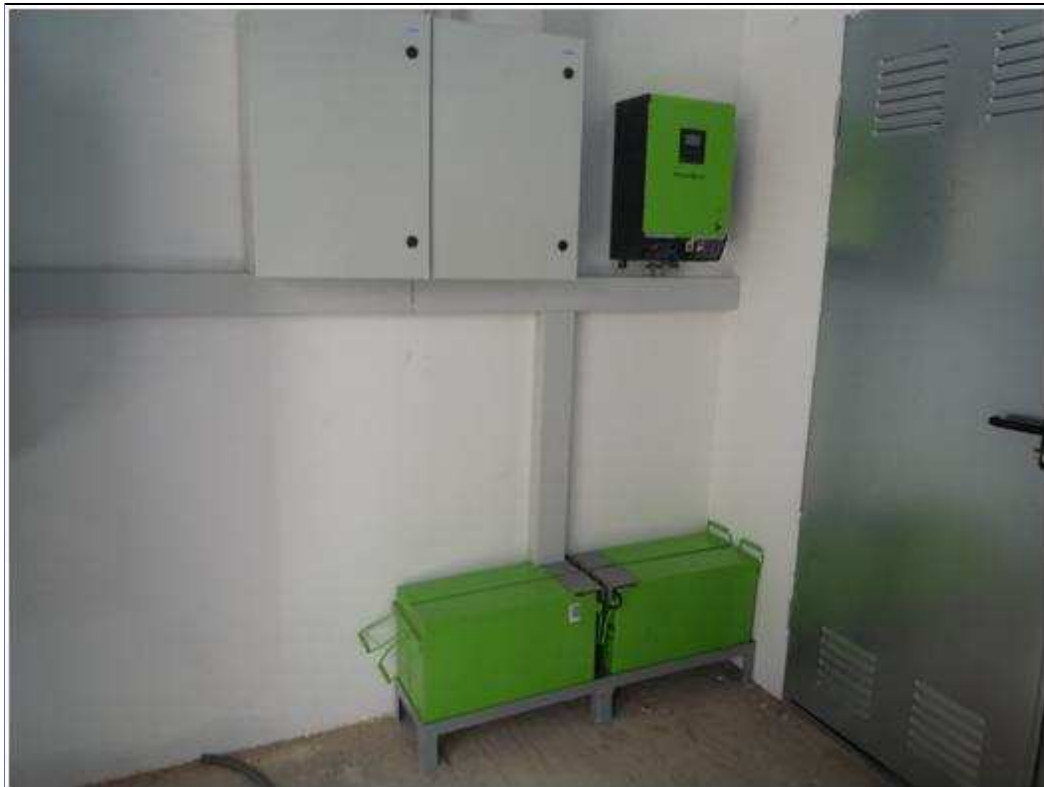
Equipo de acumulación eléctrica e inversor.
