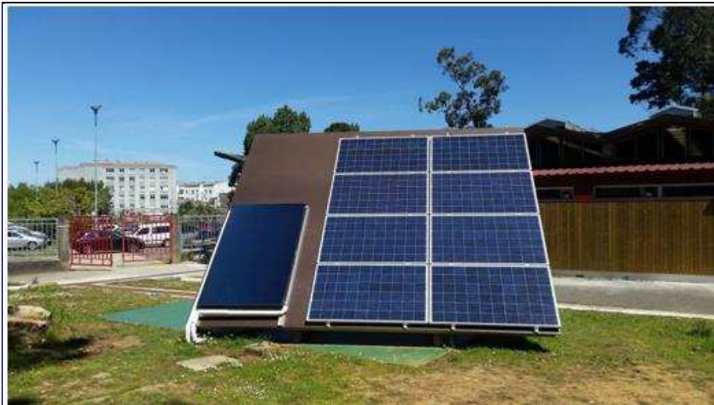
Placa solar térmica de apoio para a produción de AQS.
